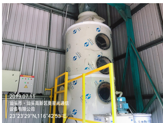
2#集中供料系统废气处理设施（喷淋）
