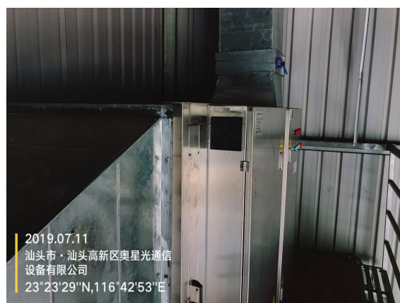
2#集中供料系统废气处理设施(UV光解、过滤)
