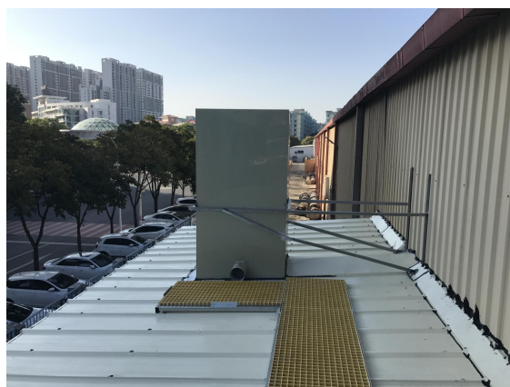
3#着色并带工序和二次套塑工序废气排气筒
