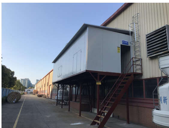
3#着色并带工序和二次套塑工序废气处理设施
